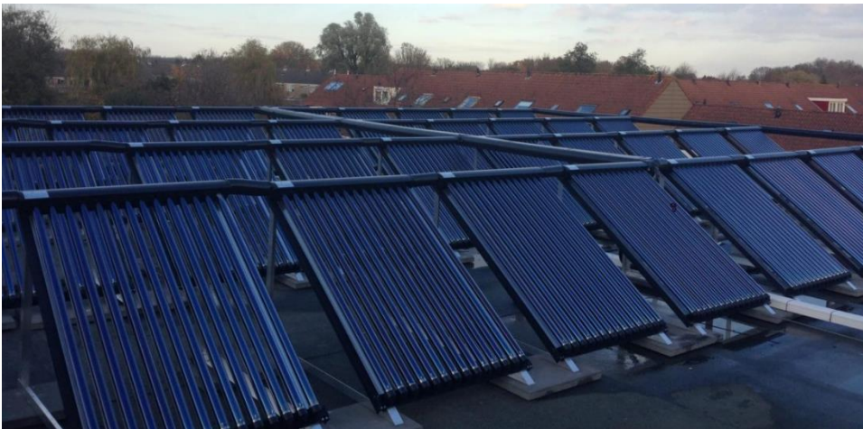
Figuur 12. Zonnecollectoren op dak (MSG Energie Zakelijk)
